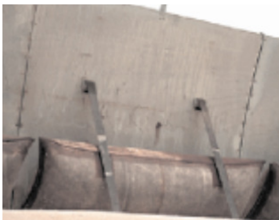
Foto 5.6: Panconi manovrati da camere ad aria gonfiabili
