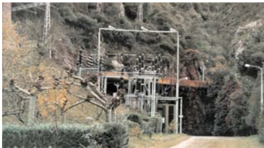
Foto 7.18 Impatto visivo di una sottostazione all'aperto
