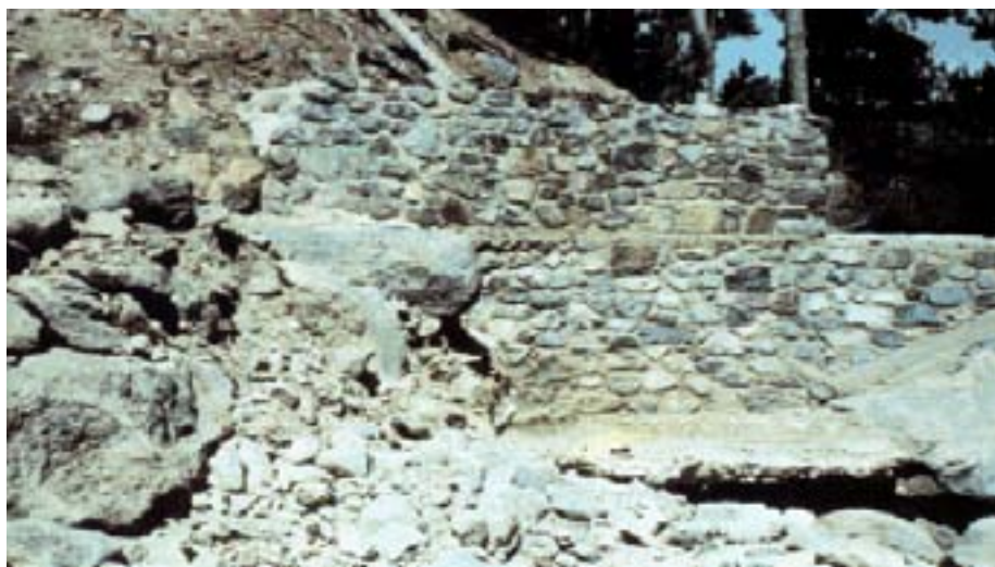
Foto 4.11: la traversa compromessa dalle infiltrazioni
