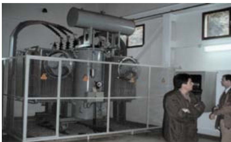
Foto 7.11: La sottostazione collocata all'interno della centrale
